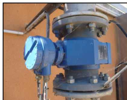
Figure 34 : Débitmètre électromagnétique en entrée de STEU
