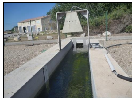
Figure 35 : Canal Venturi et sonde US en sortie STEU
