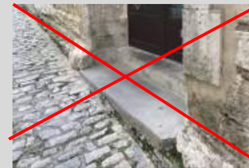
Traitement de seuil en ciment inadapté qualitativement
