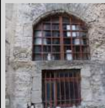
Menuiserie non conforme au style architectural (invention), possibilité de créer un vitrage plein dans une écriture contemporaine
