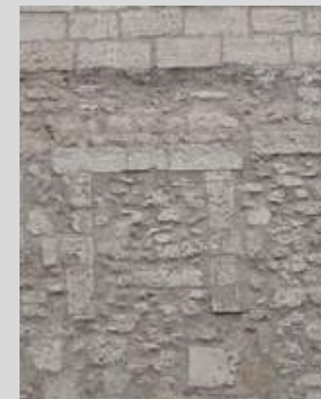
Percement bouché pouvant être réouvert. Dans le cadre de travaux la mise en œuvre d'un enduit sur les pans de murs est obligatoire.
