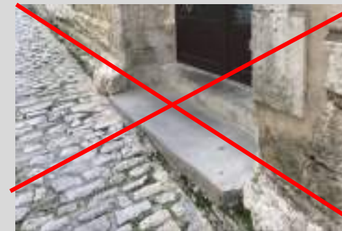
Traitement de seuil en ciment inadapté qualitativement
