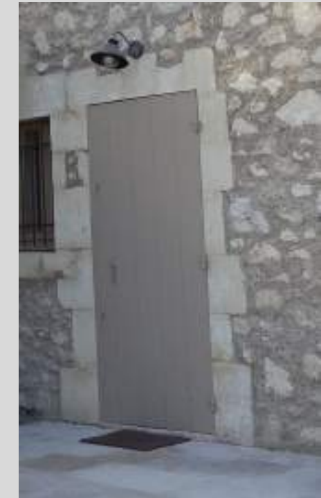
Exemple de porte à planches croisées. Si le dessin et la réalisation de la porte conviennent, il est regrettable qu'elle ne soit pas posée en retrait ou en feuillure
