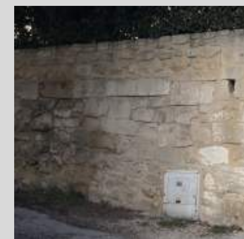
Le couronnement ne présente pas une régularité parfaite ce qui répond mieux aux murs de pierres sèches.
